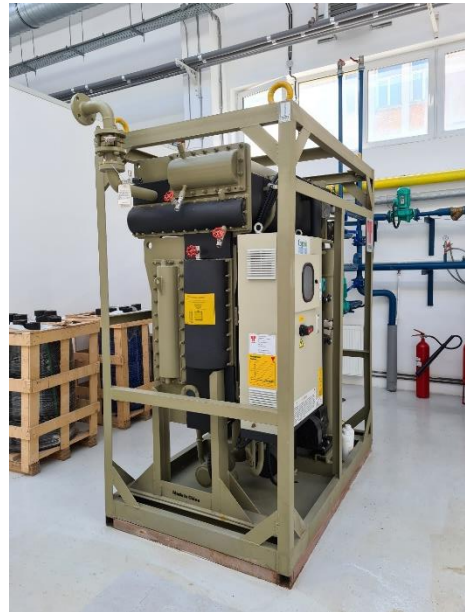
i) Laborator cogenerare-trigenerare;
