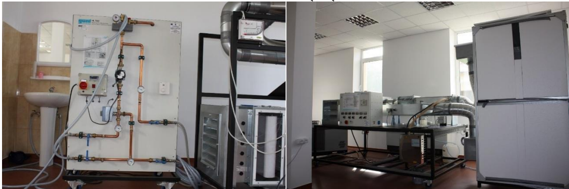
Stand de cercetare aer condiționat cu incintă climatică
